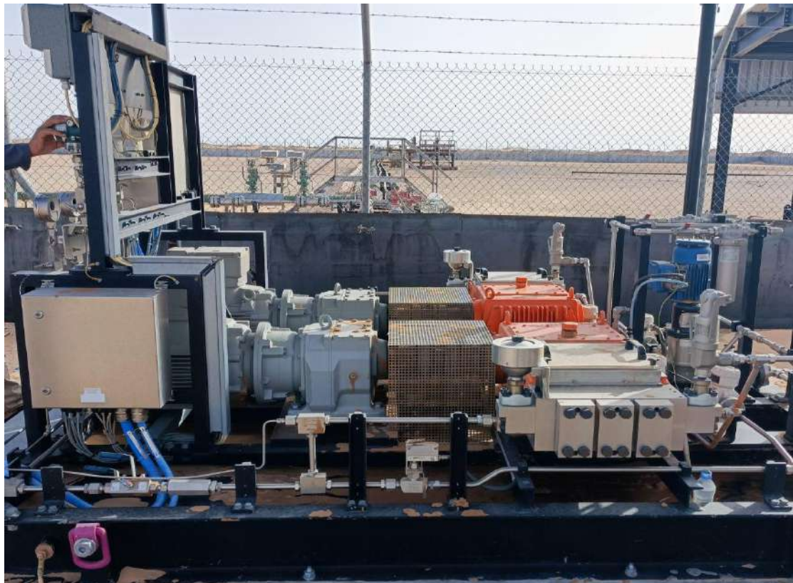
Figure A .III : les pompes triplex utilisé pour pompé l'inhibiteur et l'eau
