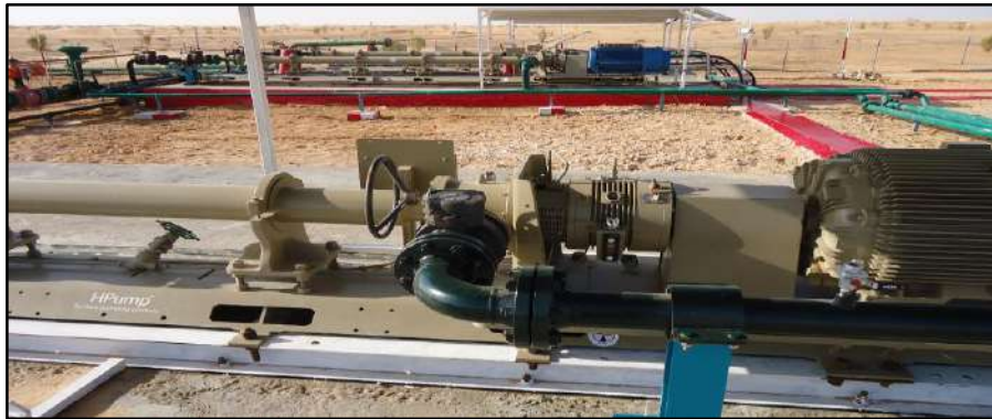
Figure I.8 : Les pompes au niveau de l'EPF RAMA
