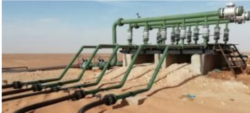
Figure.III.11.Manifold de collecte MFD OKN 54 [7]
