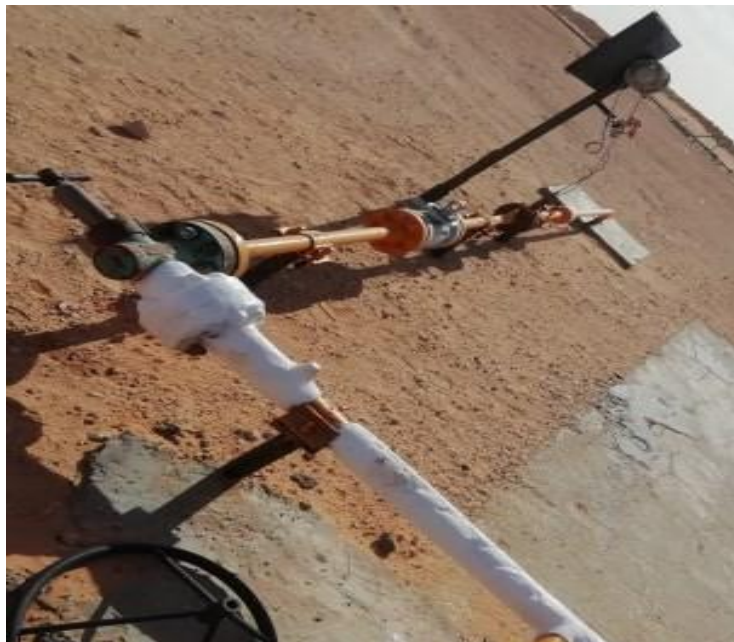
Figure.III.10.BKHC# 01.Installation de surface d'un puits GLS[7]
