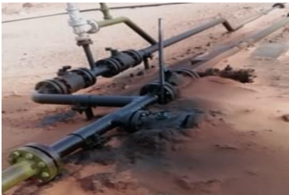
Figure.III.7. Fuite sur la vanne de départ et vanne d'isolation de la soupape du puits OKN # 02 [7]
