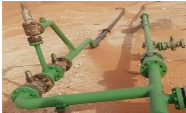
Figure.III.8. Manque 04 Boulons sur la vanne de départ et vanne d'isolation de la soupape du puits OKS# 34 [7]
