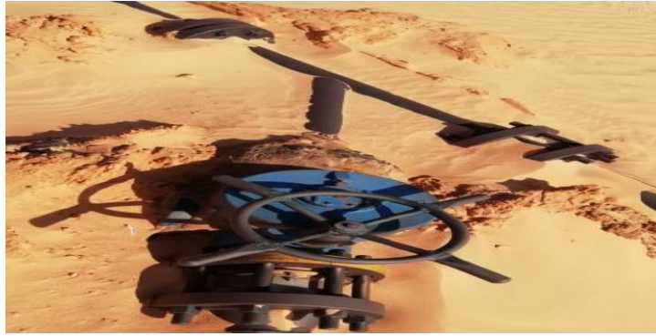
Figure.III.9. OKP#88 : Clapet et vanne de garde au niveau du point de jonction au réseau [7]
