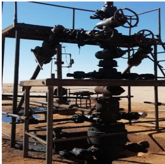
Figure.III.4.BKP #02 .Tête de puits trop sale[7]
