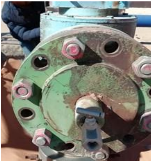
Figure.III.3.OKN HA #01 Manque Boulons sur bride de la vanne latérale[7]
