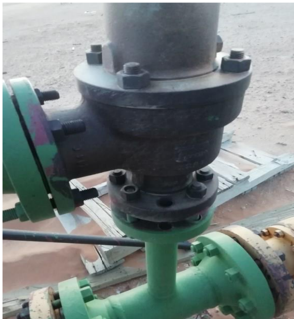
Figure.III.5. Manque des Boulons du PSV sur un puits à huile OKN # 17 [7]
