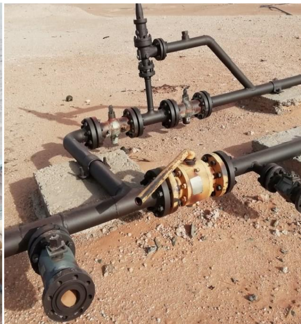
Figure.III.6. État de la soupape au niveau du puits à huile OKN # 461[7]
