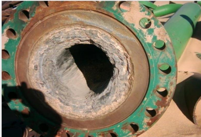
Figure II.15 : Dépôt de BaSO 4 au niveau de la duse [1]
