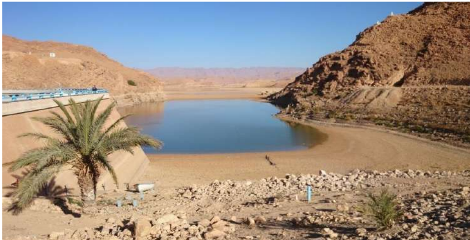
Figure V.2. Etat critique du barrage de Fom El Gherza en Novembre 2014.
