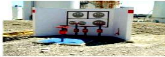
Figure 18 : vannes déluge manuelles protégées par un mur coupe-feu [19]
