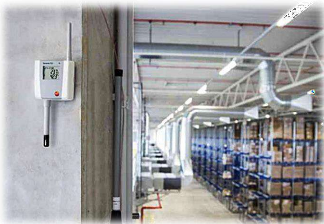
Figure I.8 : surveillance d'un critical control point au moyen d'un enregistreur de données testo 175 t1
