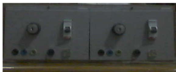
Figure III.3 Le panneau d'alimentation principal utilisé.
