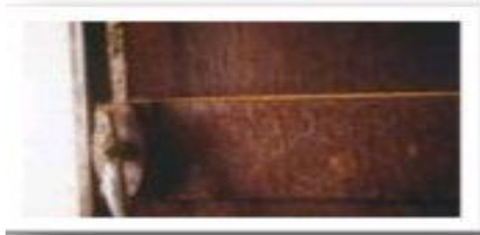
الشكل I-2-1- صورة تآكل المنتظم [9]
