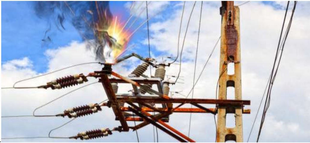
Figure I.4 défaut dans le réseau électrique
