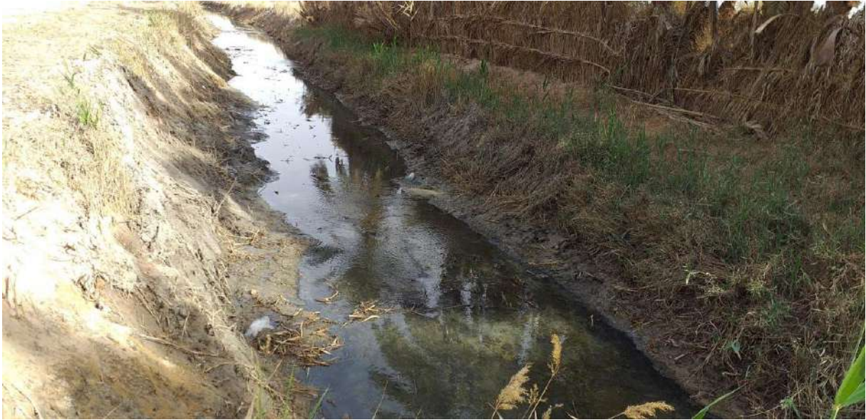
Figure I.01 : Etat de drain
