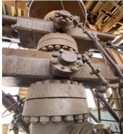
Fig.III.4 : Manque d'un boulon
