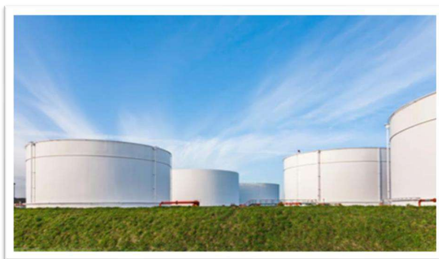
Figure II.9. Stockage de chaleur dans des réservoirs d'eau.
