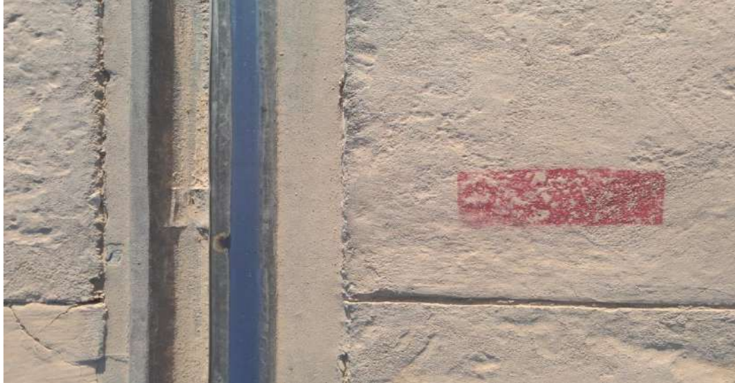
Figure III.7 : Joint de soudeur du rail d'Ouargla
