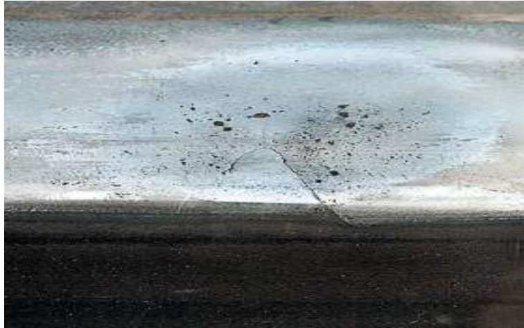
Figure I.6 : déformations des rails[9].
