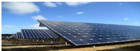
figure1-6 : centrales solaires photovoltaïques (PV)
