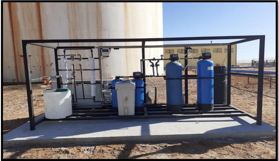
Figure III.1: Unité pilote de traitement d'eau
