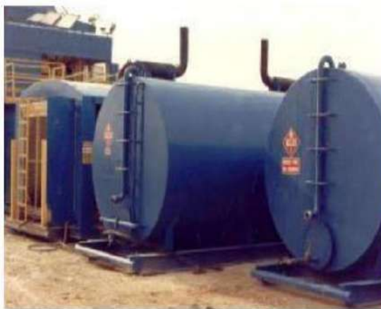
Figure 40 : Réservoirs de stockage de carburant
