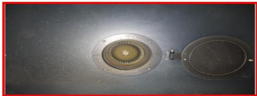
Figure (II-10) : Ventilateur intérieur
