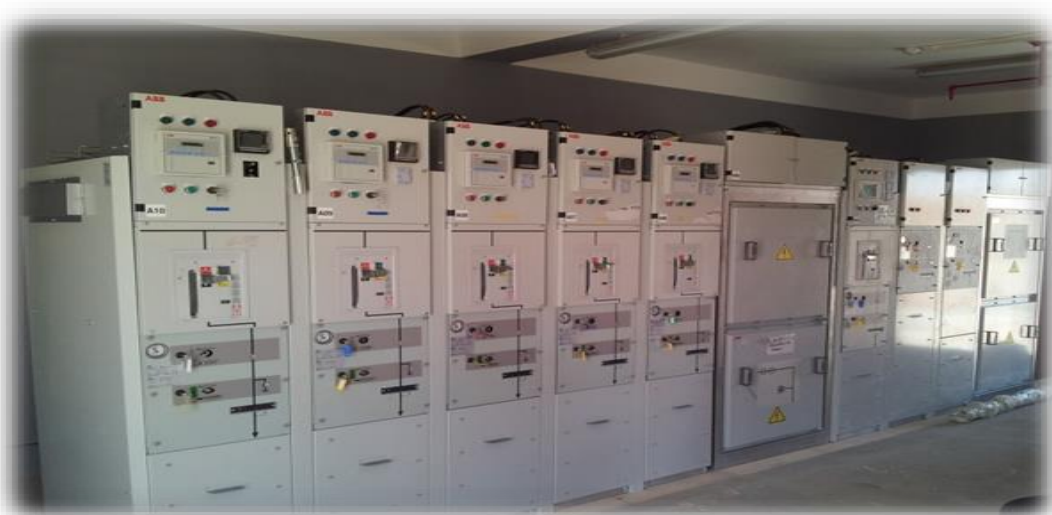
Figure I. 31 : Post d'évacuation moyen tension – HTA.
