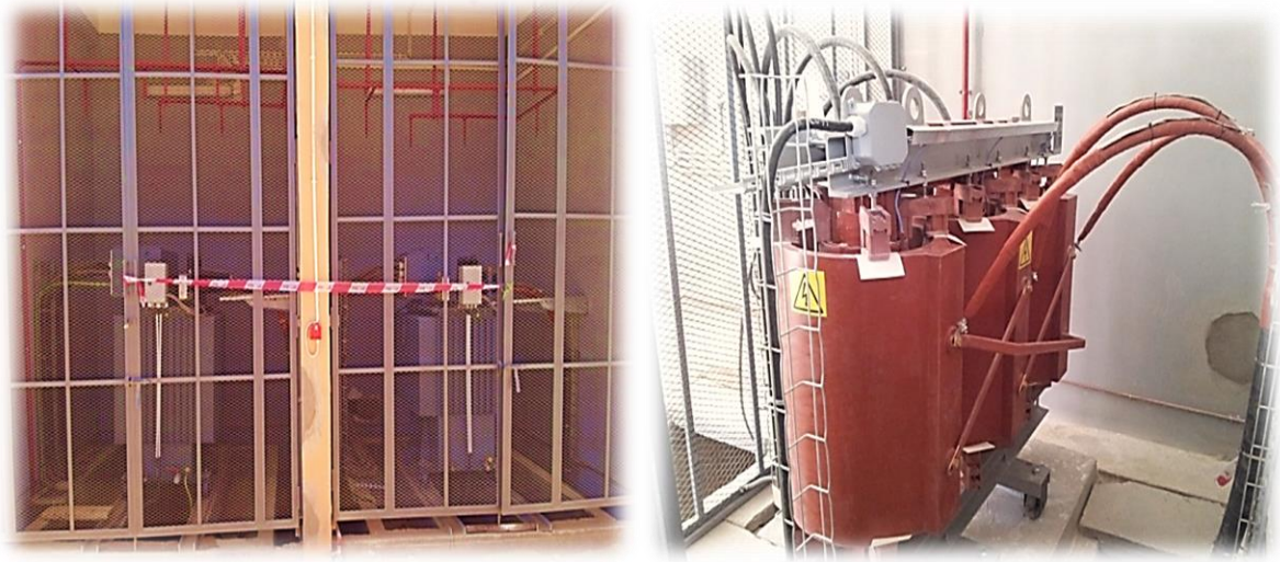
Figure I.32: Les transformateurs existants dans la centrale.
