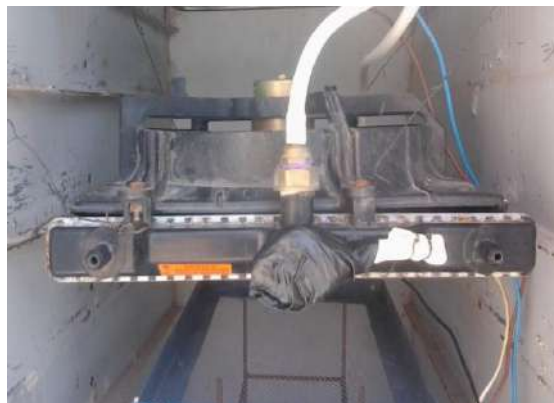
Figure (II.7) : Échangeur de chaleur à l'intérieur de la chambre de séchage
