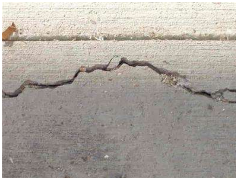
Photo II.1 : Fissuration du béton
