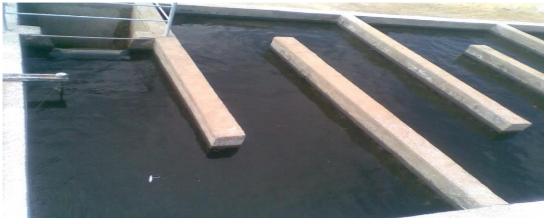
Photo 8: Bassin de chloration
