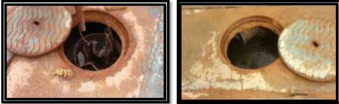
Photo 3: Les composants de la fosse septique.
