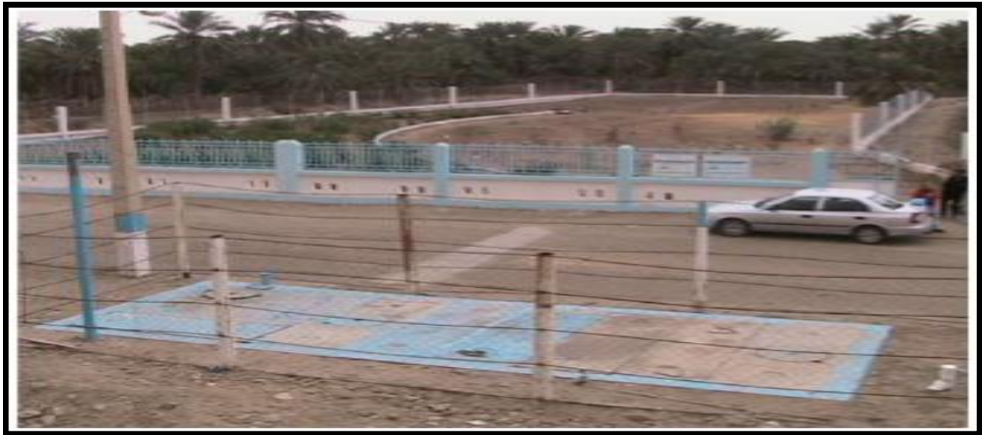
Photo 1: Station d'Épuration des Eaux Usées Waste water Garden, Vieux Ksar de Témacine.
