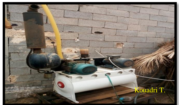
Photo N° 4: Pompe à vide au niveau de la ferme Bouhafes
