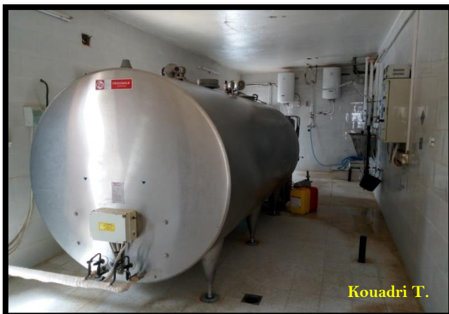
Photo N° 12: Réservoir de refroidissement et de stockage du lait ; la capacité de stockage 6000(L) au niveau de la ferme ben hadide
