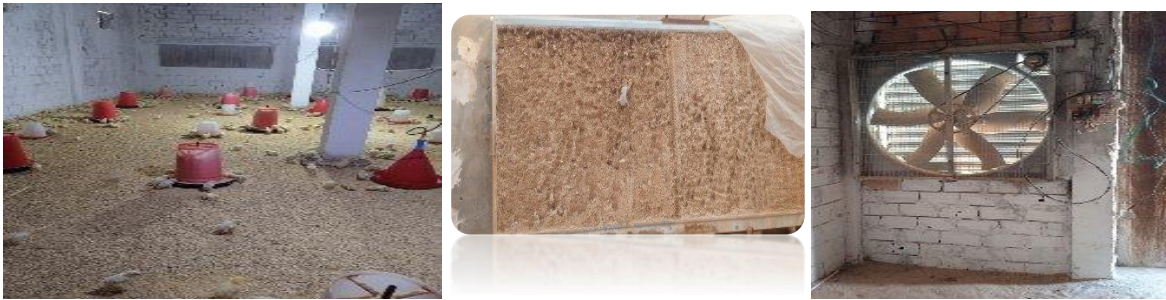
a- Le système de refroidissement Pad –Cooling
