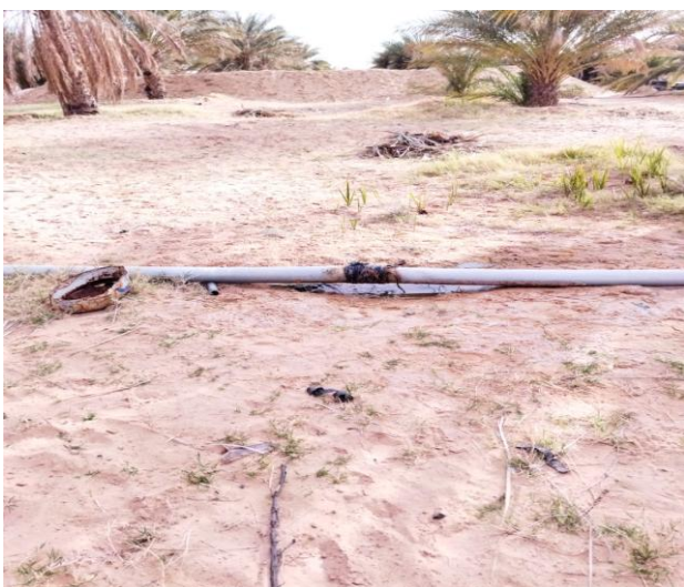
détérioration du réseau d'irrigation
