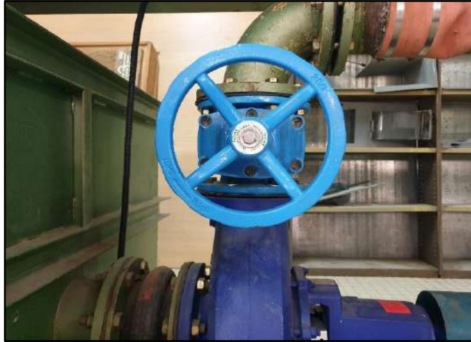
Photo 1. 4 : Vanne de réglage.
