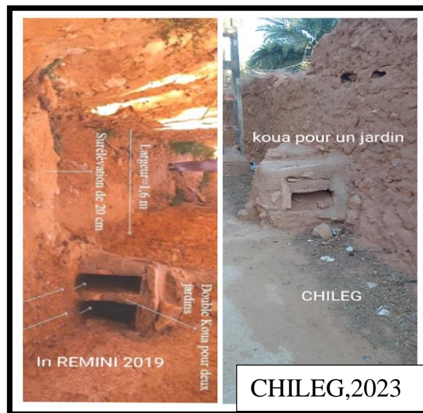
Figure 19. koua (alimentant jardins consécutifs) située dans une seguia secondaire très dégradée et non entretenue
