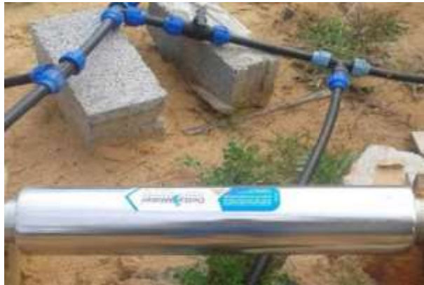
الصورة (22): تركيب جهاز تفكيك الأملاح قبل الري
