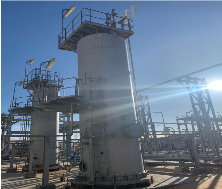
Figure [2-13] : Réservoir de stockage l`air comprimé (Depuis le champ)
