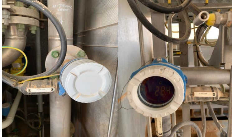
Figure [2-8] : Transmetteur de température (TT) (Depuis le champ)
