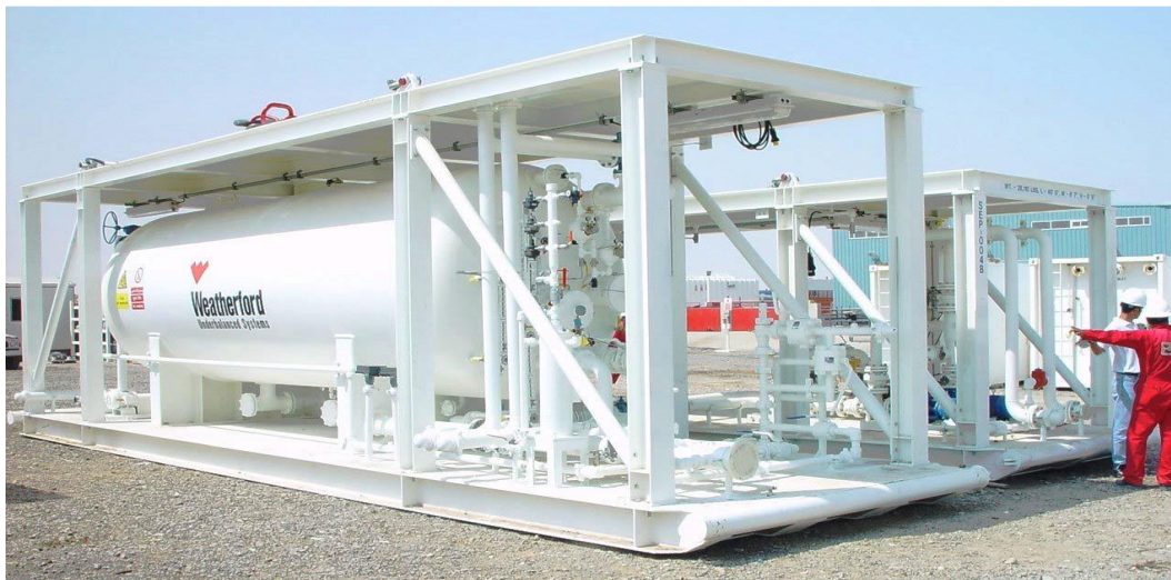
Figure II- 10: Séparateur Horizontal sur chantier
