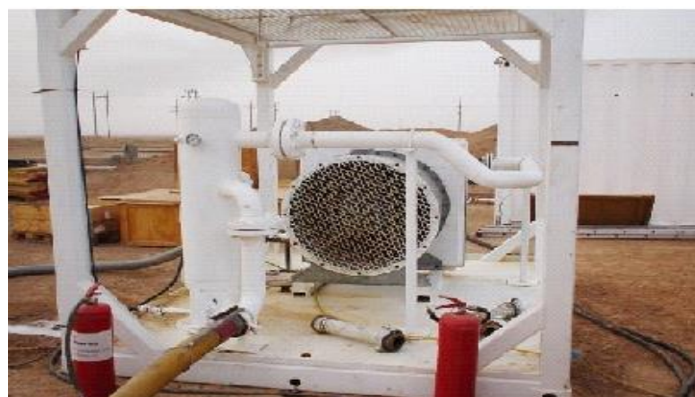
Figure II- 4:Refroidisseur (Air Cooler)
