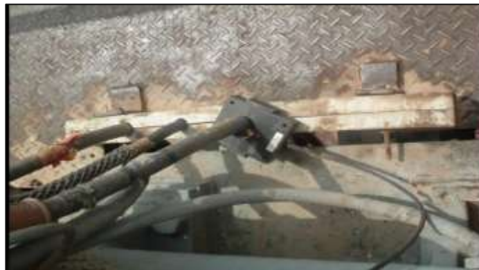
Figure 27 : Position Capteur de Torque sur le câble d'alimentation
