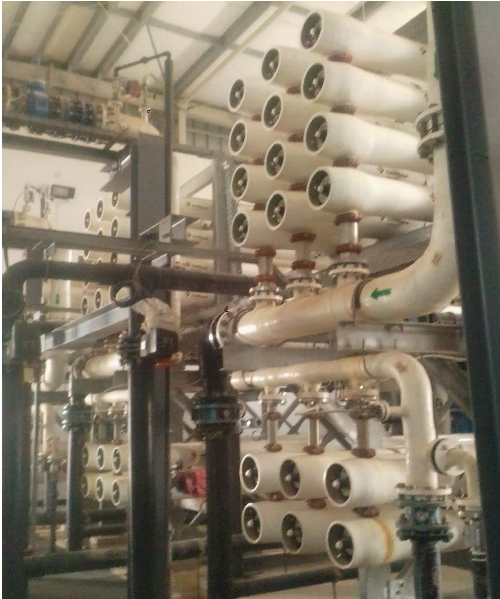
Figure 18 Unité d'osmose inverse
