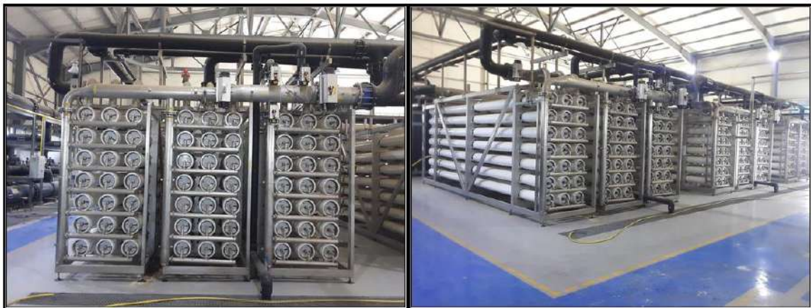
Figure II.9. Unité d'osmose inverse.
