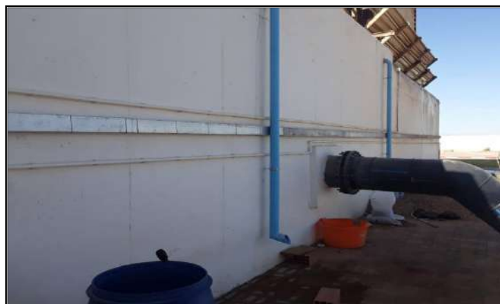
Figure II.5. Réservoir de stockage des eaux brutes.
