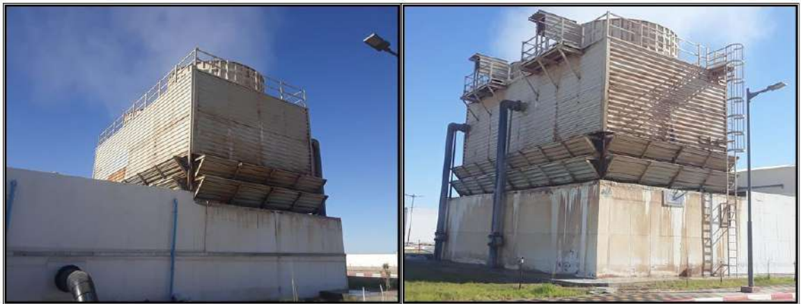
Figure II.4. Une tour de refroidissement.
