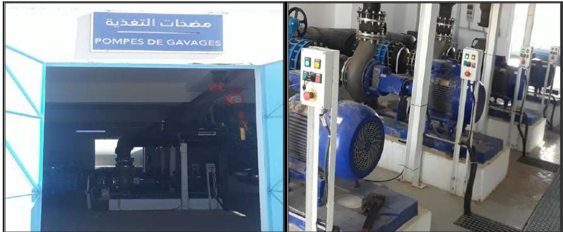
Figure II.6. Pompe d'alimentation des filtres à sable.
