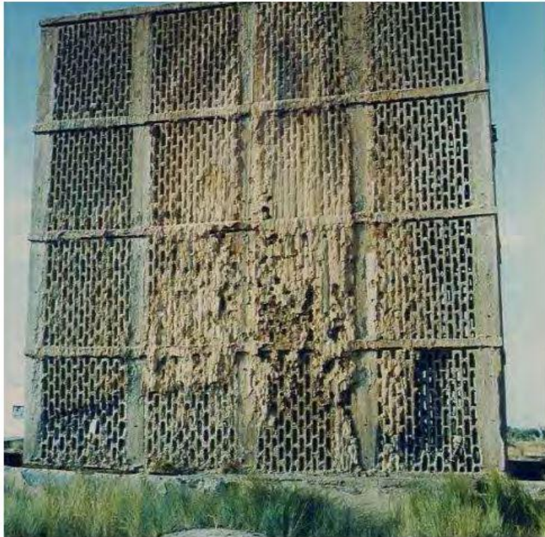
شكل (3-6): تآكل منشآت التبريد المياه بفعل الملوحة.
