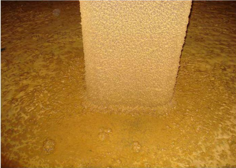
شكل (3-8): ترسب الكلس داخل أحواض تخزين المياه.
