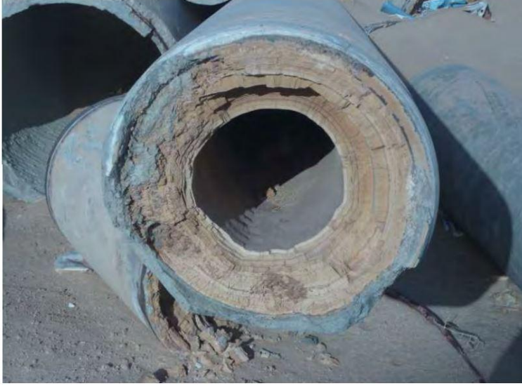
شكل (3-7): ترسب الكلس داخل قنوات توزيع المياه.
