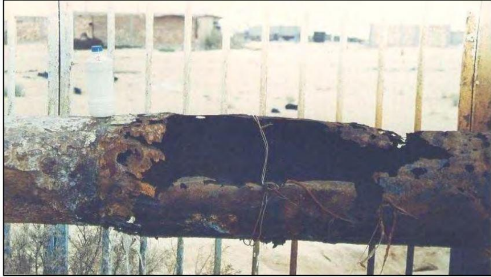
شكل (3-5): تآكل قنوات جلب المياه عند الآبار بفعل الملوحة.
