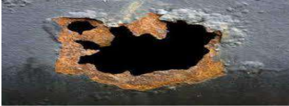
Figure 2 Corrosion par piqûres (piqûre)
