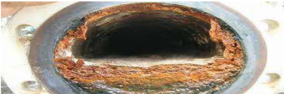
Figure 7 Corrosion par micro-organismes (MIC)
