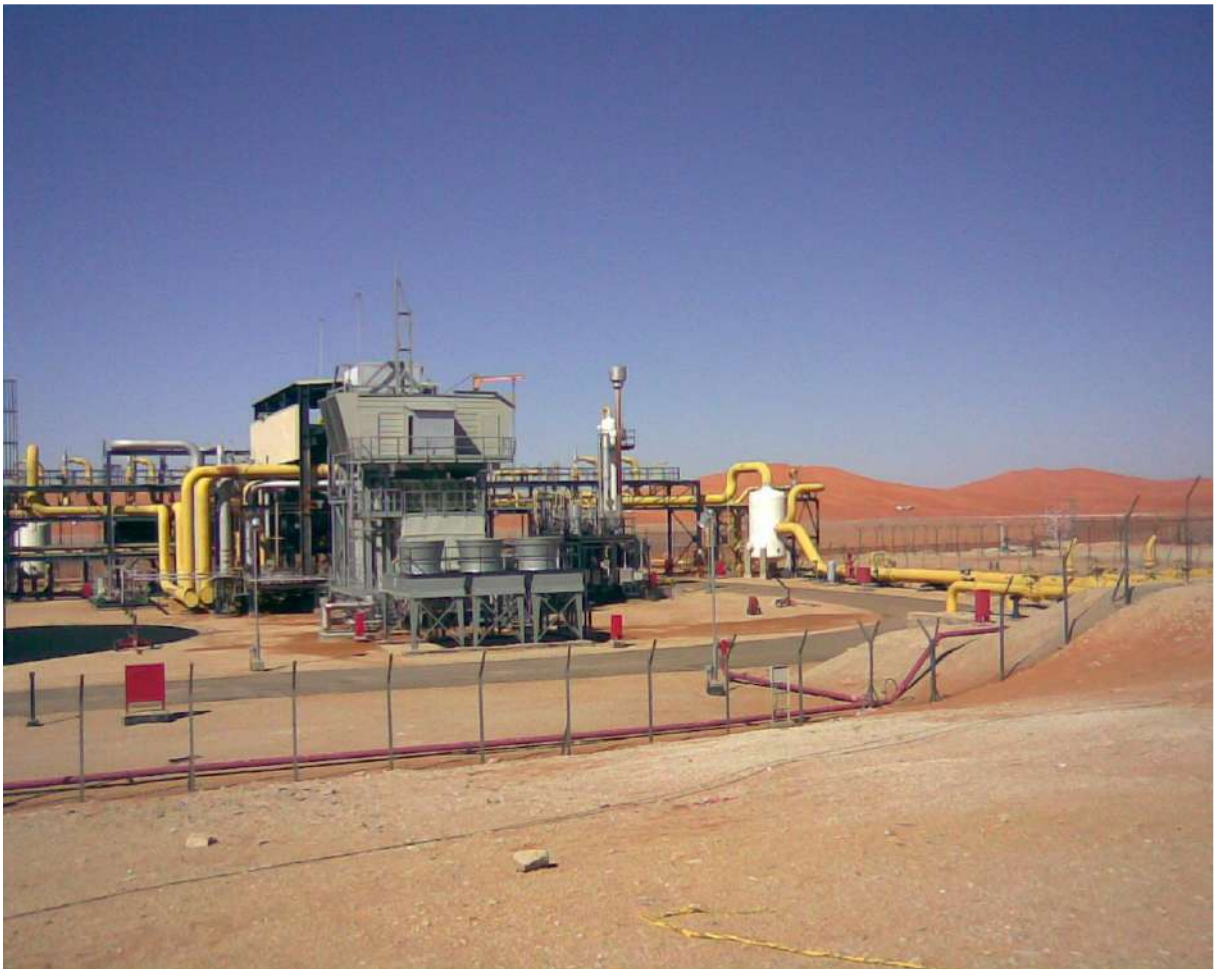
Figure (IV.1) : Vue générale de l'unité RGTE.
