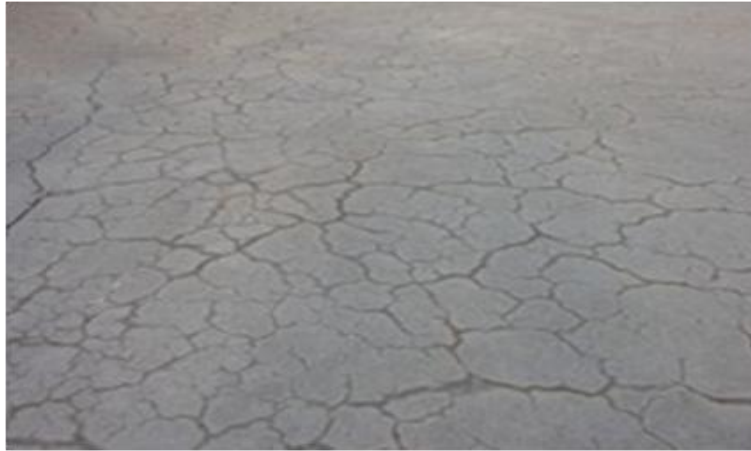
Figure 2.2 : Fissuration de peau du béton [38].
