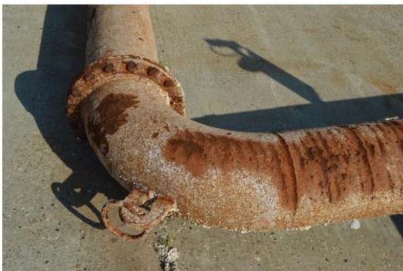
Figure.I.1 : exemple de la corrosion électrochimique
