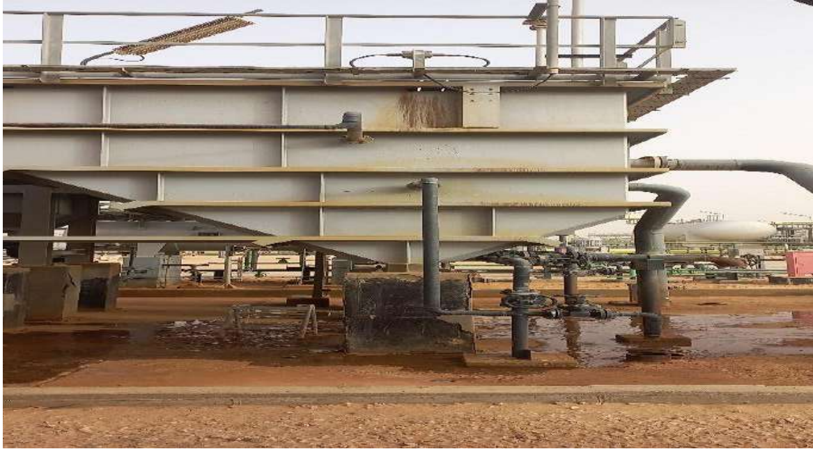
Figure1 : Le séparateur d'eau et la sortie des rejets (eaux industrielles).
