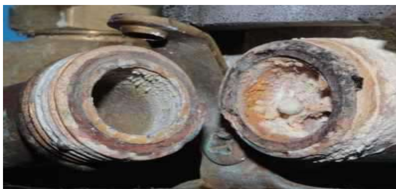
Figure II.16 : corrosion sélective des tuyaux en laiton.
