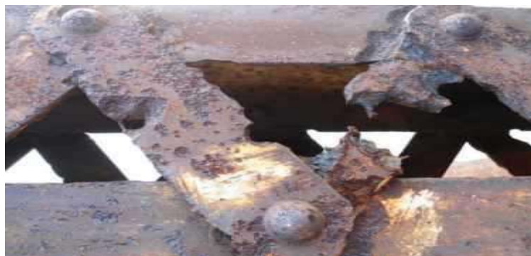
Figure II. 14: corrosion par piqûres.
