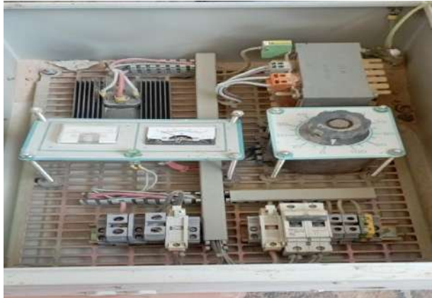
Figure IV.3 : Poste soutirage -redresseur.
