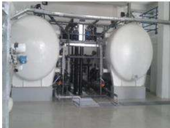
Figure III.6: ligne de filtre à sable
