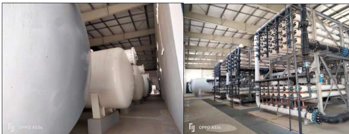
Figurer 27 : filtres à sable(6) et Membrane 3
