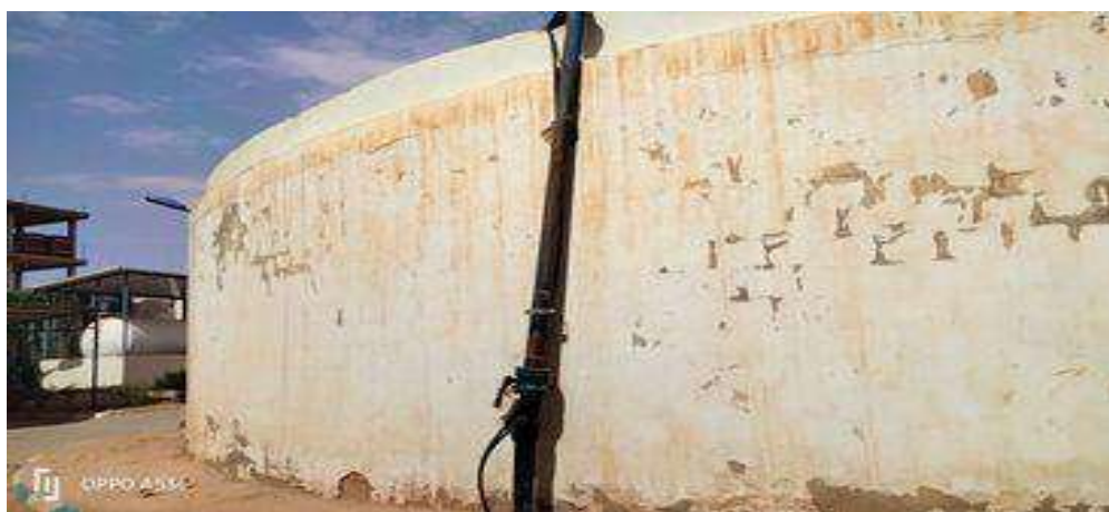
Figurer 8 La Bâche d'eau à la station de GHARBOUZ
