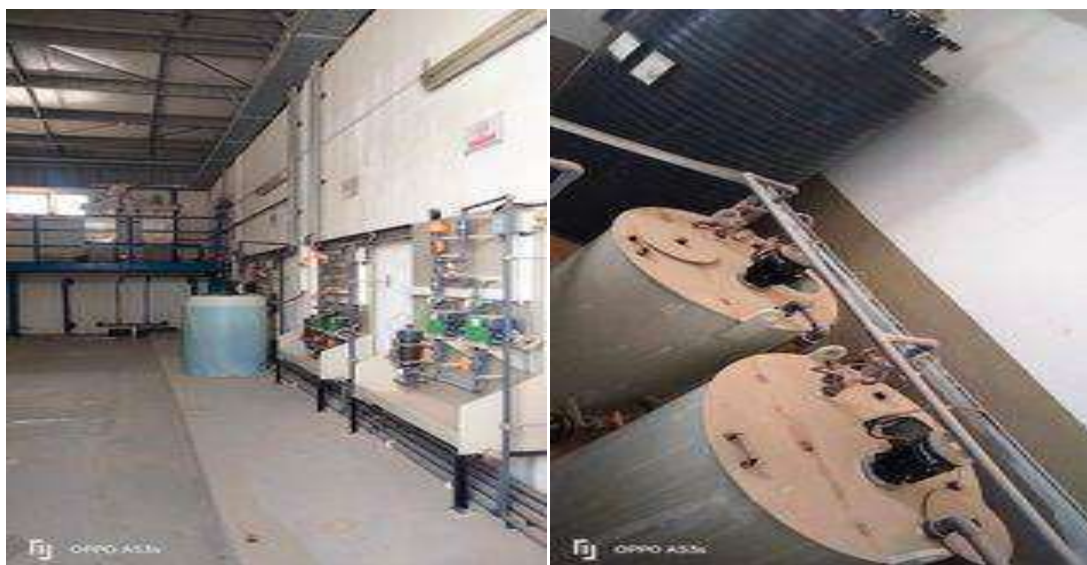
Figurer 5 Bâtiment de chloration de l'intérieur Et des réservoirs pour chlore liquide et solide
