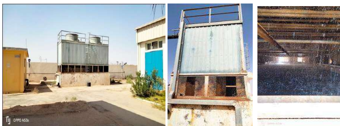
Figurer19 Dispositif de refroidissement par eau
