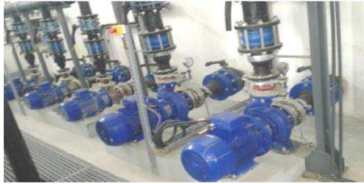
Figure III.5 : La pompe de gavage
