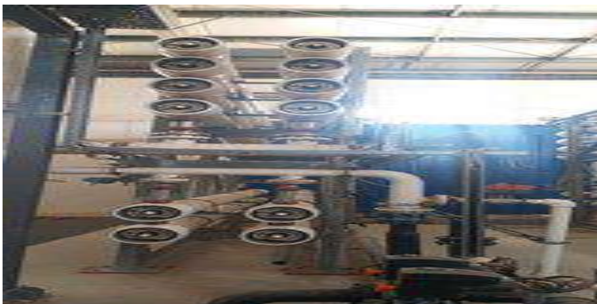
Figurer 16 Les membranes 12 (8 au-dessus et 4 en dessous
