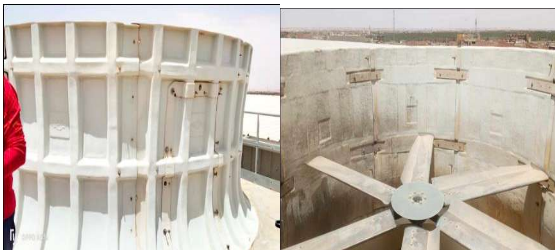
Figurer 26 : Ventilateurs de refroidissement à eau
