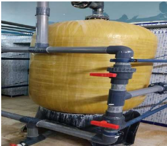
Filtre à sable
