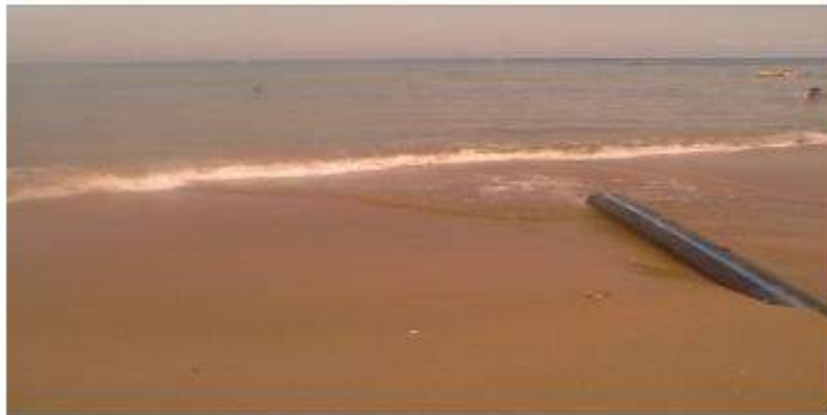
Figure III.2: L'évacuation directe de la saumure de station de dessalement de palm Beach dans l'eau de mer, Algérie
