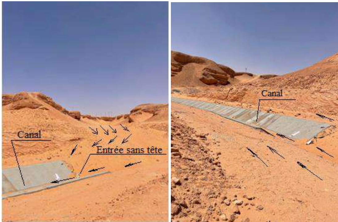
Figure (3.11) : Absence d'ouvrage d'entrée (tête d'ouvrage) dans le canal. Les flèches indiquent l'écoulement à l'entrée de l'ouvrage.
