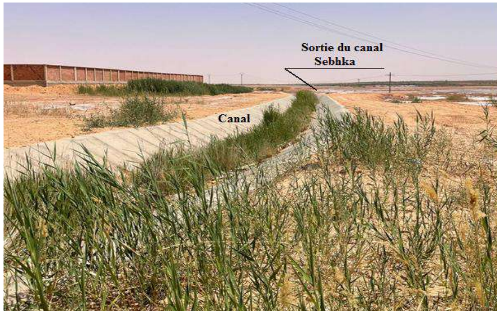
Figure (3. 13): Poussée de la végétation (roseaux) à l'intérieur du canal.
