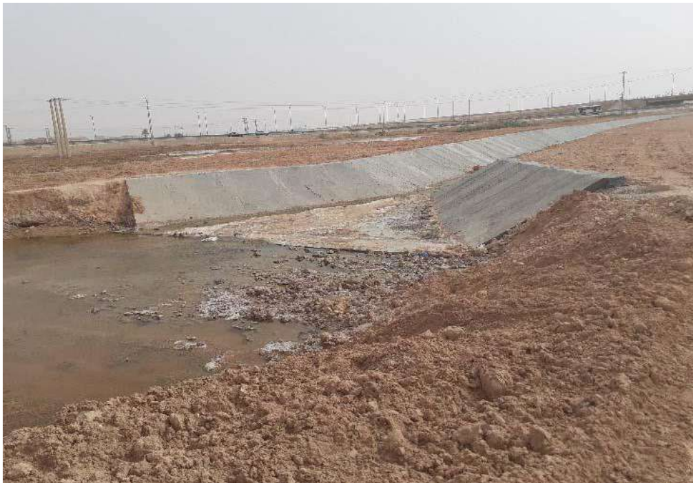
Figure (3. 7) : Déversement des eaux sans protection de la fin du canal contre l'affouillement.
