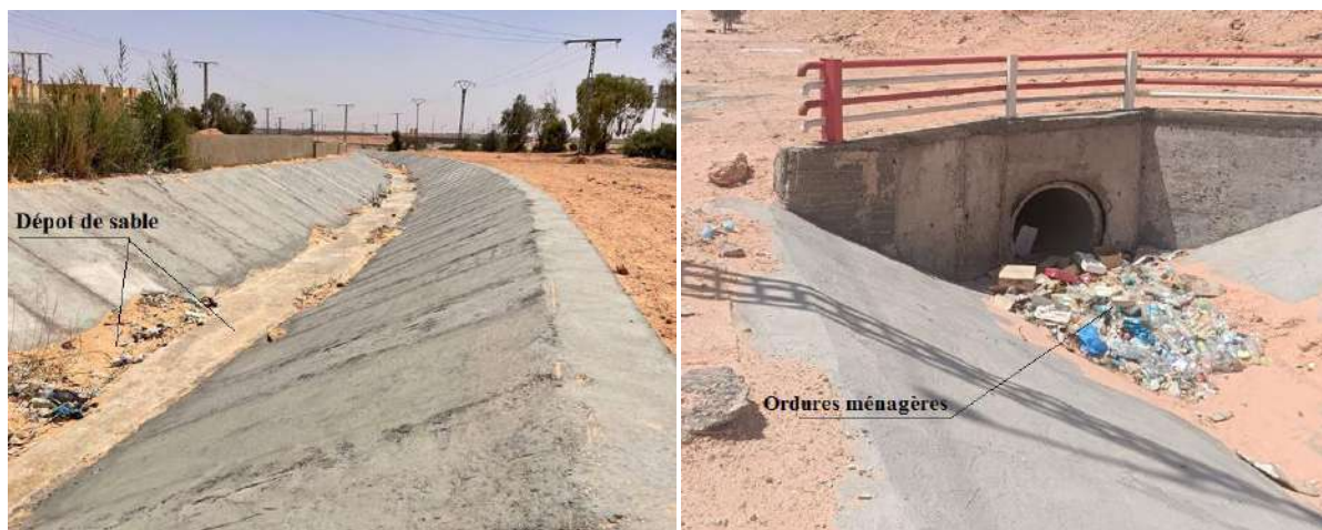
Figure (3. 14) : Dépôt de sable et des ordures ménagères à l'intérieur du canal.
