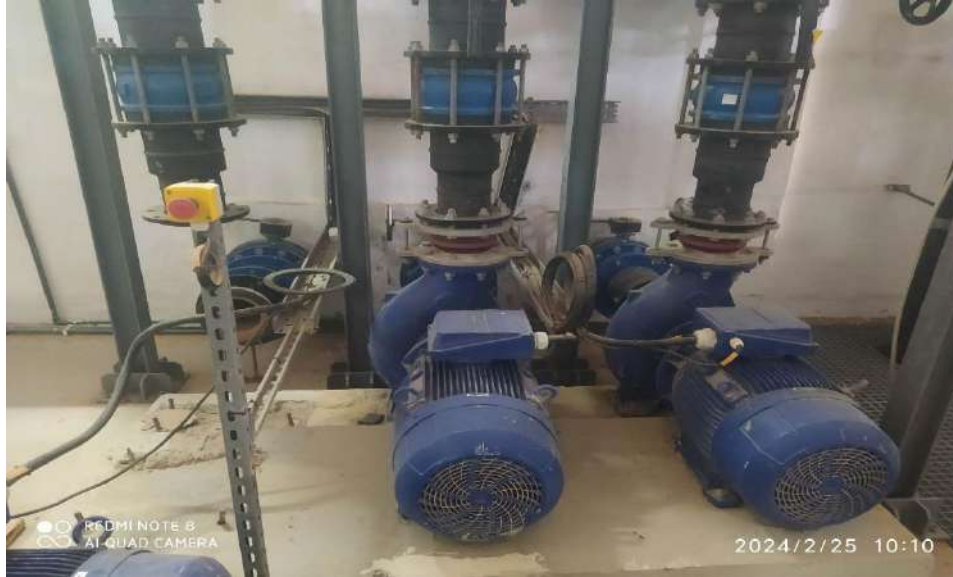
صورة V1 توضح مضخات التغذية لمرشحات الرمل
