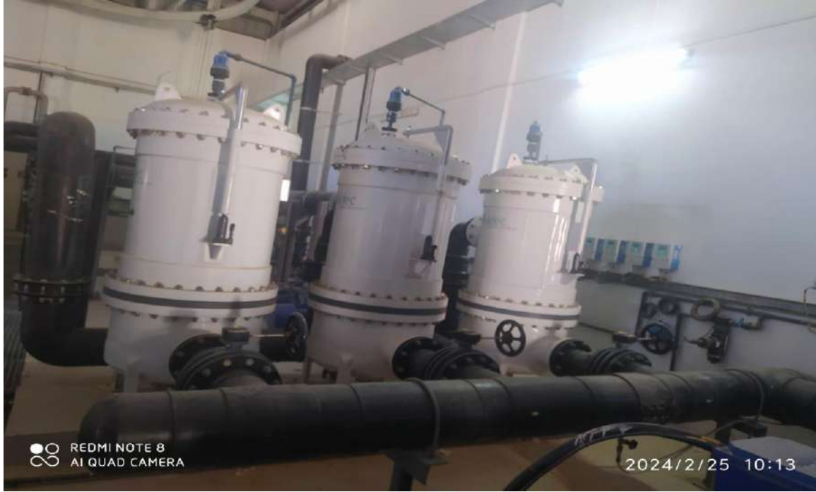
صورة V3 توضح مرشحات الخرطوش للمحطة
