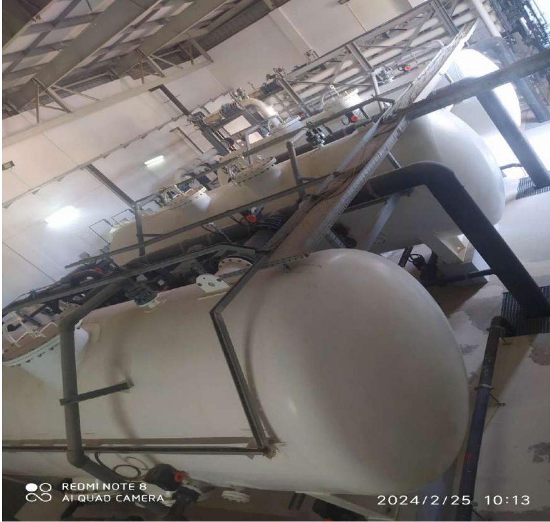
صورة ٧٢ توضح المرشحات الرملية في المحطة:
