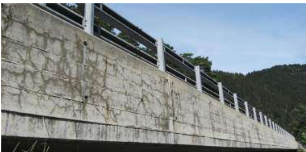
Photo II.1: fissuration du béton due au l'alcali-réaction [27].
