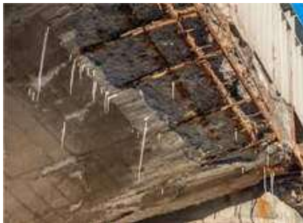
Photo II.2: dégradation due aux cycles de gel/dégel [26].
