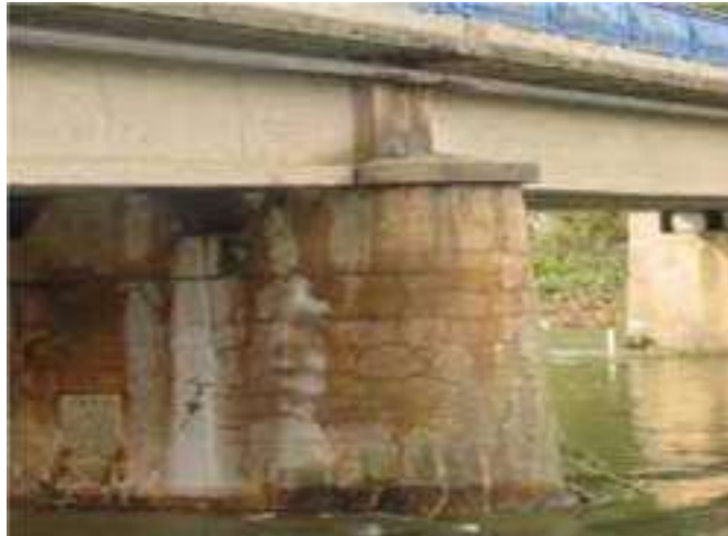
figure II.1: Les attaques sulfatique
