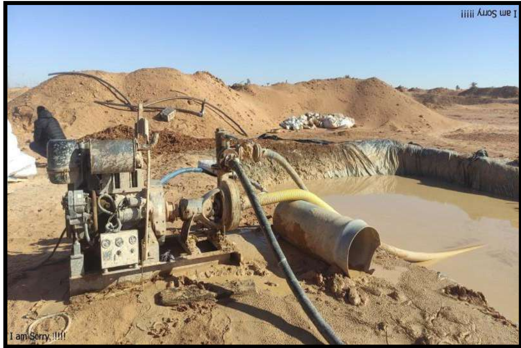
Photo N°16 : La pompe à boue de forage Hassi Chetaa
