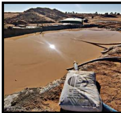
Photo N°15 : le bassin à boue de forage Hassi Chetaa
