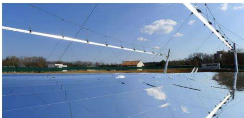
Figure I.4 Centrale solaire thermodynamique à miroirs de Fresnel [4]
