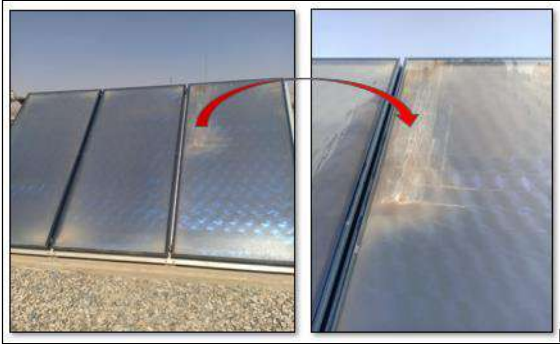
Figure II.13 : Présence calcaire sur panneau de soleil
