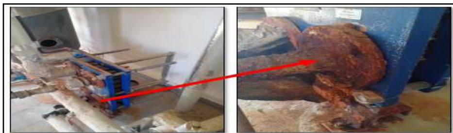
Figure II.12: Corrosion bride échangeur
