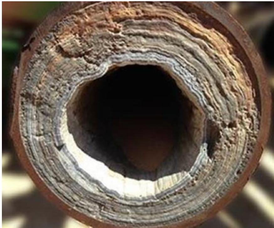
Figure II- 20: Bouchage par tarte d'un conduite
